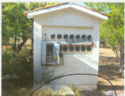
F3: Área para instalación de Wathorímetros
