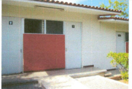
F4: Puertas CAPCE del edificio de Aulas
