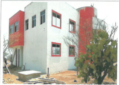
F1 Colofno de losa de entresuelo, columnas, casillitas, muro de tabique de 14 cm
