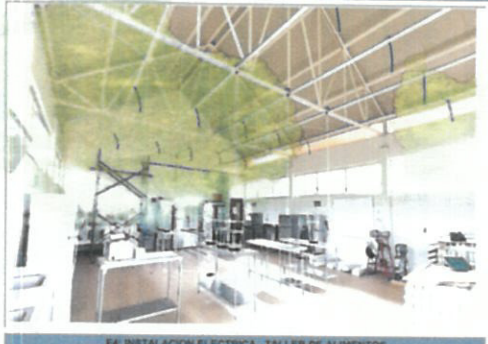
F4. INSTALACION ELECTRICA, TALLER DE ALIMENTOS
