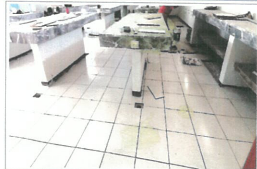
F2. PISO DE LOSETA, LAB. DE INVESTIGACION
