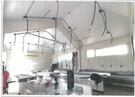
F1. INSTALACION ELECTRICA Y DE GAS, LAB. DE INVESTIGACION
